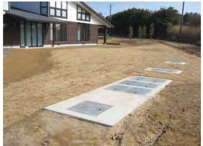
一次処理槽、消毒・貯留槽(手前)、 土壌浸潤槽(奥の芝生広場)
