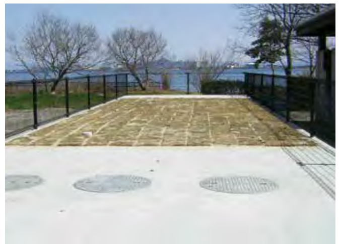
手前：FRP槽、奥：土壤浸潤槽
