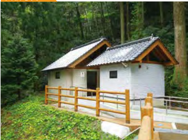
手前：土壌浸潤槽
