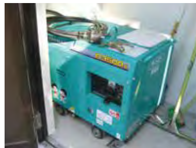
非常用発電機
