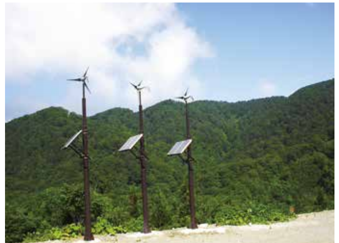
駒ヶ岳 発電システム
